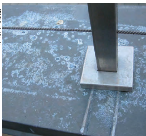
Rys. 6. Wykwity białej korozji cynku na blachach tytanowo-cynkowych
