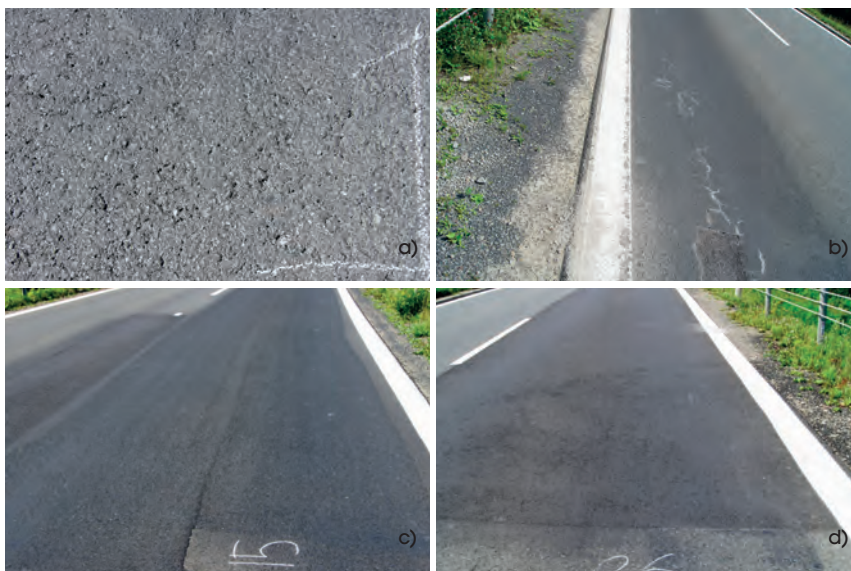
Rys. 3. Stan warstwy ścieralnej nawierzchni: a) widok uszkodzeń powierzchniowych, b) spękania i wysięk wody, c), d) naprawione powierzchnie
