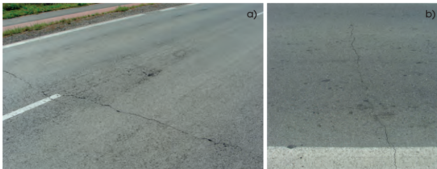
Rys. 1. Spękania poprzeczne remontowanej nawierzchni asfaltowej: a) spękanie z wykruszeniami mastyksu, b) spękanie nowo powstałe
