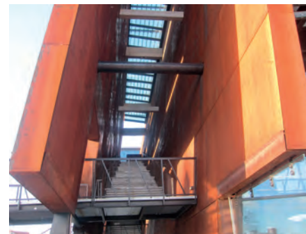
Rys. 5. Fasada obiektu użyteczności publicznej ze stali odpornej na korozję atmosferyczną – ECS Gdańsk
