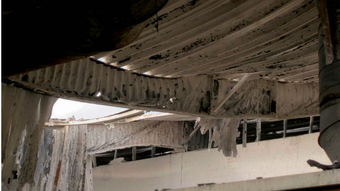
Rys. 1. Zniszczone dźwigary stalowe po pożarze hali odlewni magnezu w Olszowej (woj. opolskie)
