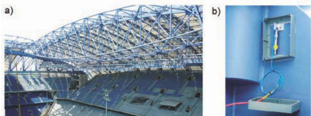
Rysunek 19. a) widok dźwigara kratowego na stadionie w Poznaniu; b) instalacja przechylomierza
