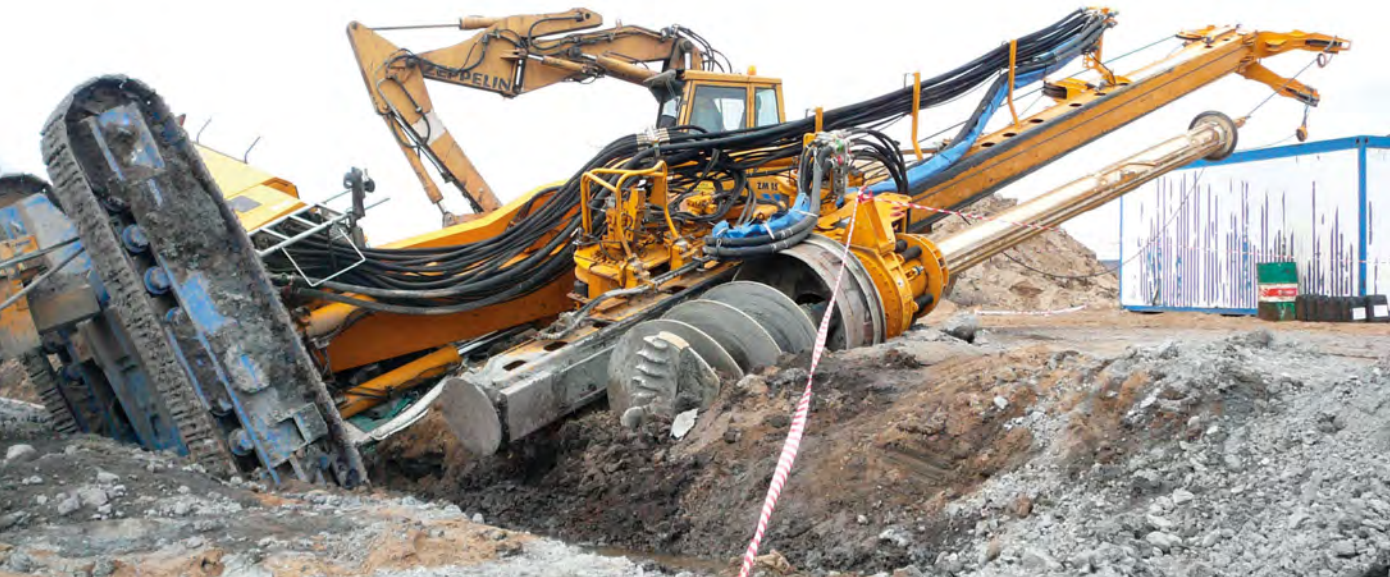
Rys. 1. Przykład niedostatecznej nośności podłoża pod gąsienicami palownicy (fot. PZWFS)
