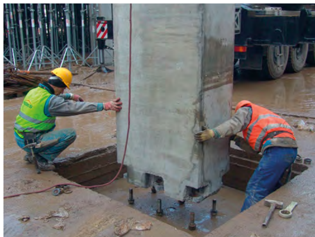
Fot. 1. Połączenie słupa prefabrykowanego z rygłem (a); przykłady połączeń sztywnych belek i słupów (b); montaż słupa prefabrykowanego za pomocą kotew fundamentowych (c)
