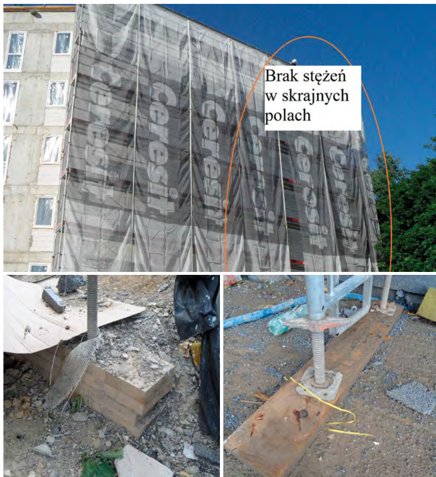
Rys. 3. Rusztowanie fasadowe (L01 w badaniach): a) całe rusztowanie, b) prawidłowe ustawienie ram na podkładach, c) ustawienie ram na podkładach, które są obciążone dodatkowo parciem gruntu
