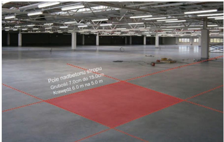
Fot. 1. Do realizacji ekspertyzy przygotowano sześć stacji pomiarowych w wybranych, najbardziej zarysowanych polach
