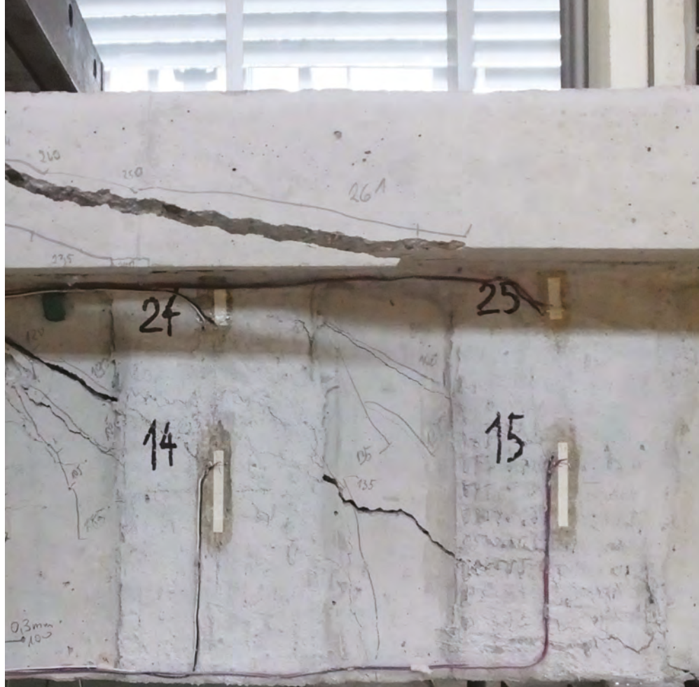
Rys. 4. Widok ukośnej rysy niszczącej, na pasku 15 widoczny poślizg włókien
