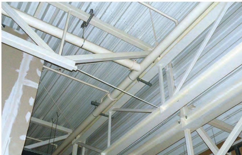
Fot. 4. Stężenie jednostronne dźwigara skrajnego – zgodnie z projektem powinien być kątownik
