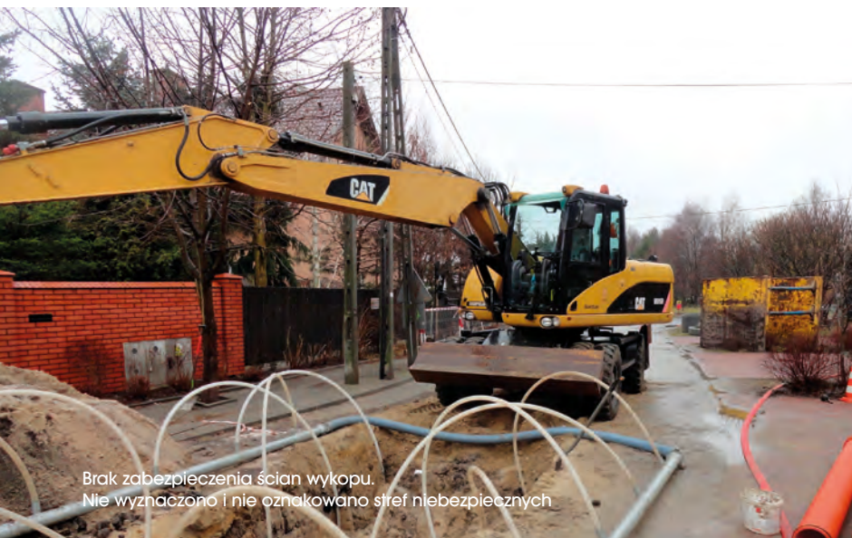
Razące naruszenie przepisów bhp podczas wykonywania montażu zbrojenia przyczółku
