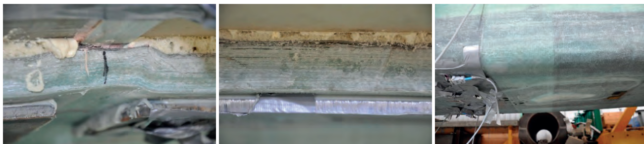
Rys. 6. Delaminacja kompozytu pasów górnych oraz pasa dolnego w środku rozpiętości dźwigara
