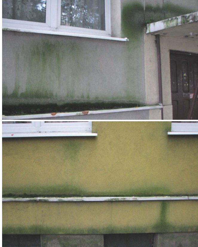
Fot. 1, 2. Skażone elewacje
