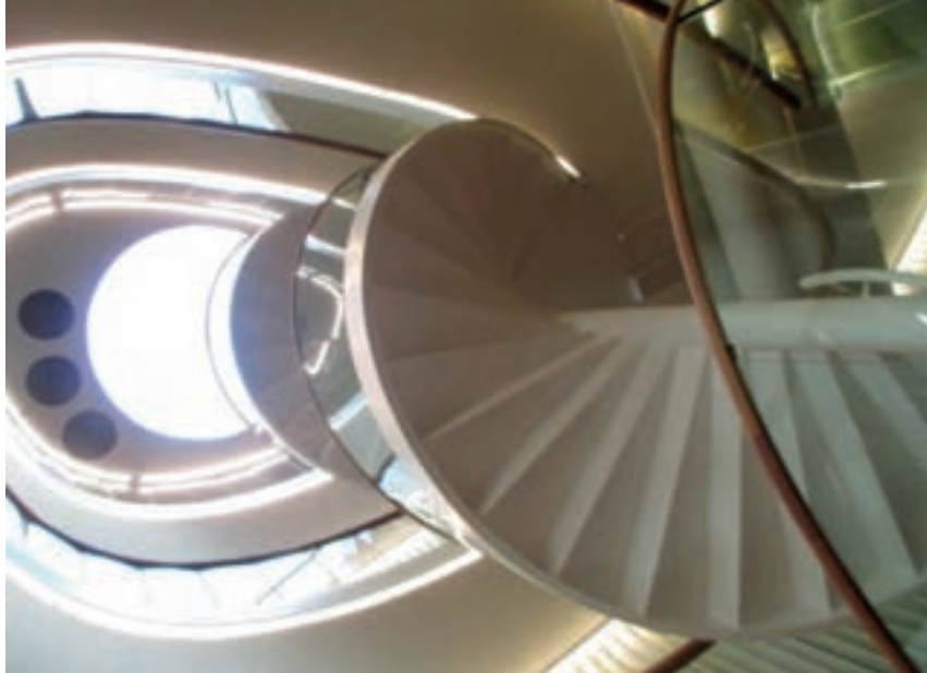
Rys. 1. Klatka schodowa w czterokondygnacyjnym budynku biurowym wykorzystywana jako niskociśnieniowy zbiorczy przewód wywiewny. W górnej części widoczne są wloty do trzech wentylatorów osiowych, przed usunięciem do atmosfery powietrze przepływa przez wymienniki do odzysku ciepła
