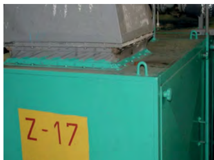
Fot. 9. Uszczelnienia w systemach klimatyzacyjnych i nagrzewnicach
