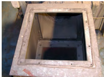
Fot. 7. Kłapa przeciwpożarowa uszczelniona sznurem azbestowym
