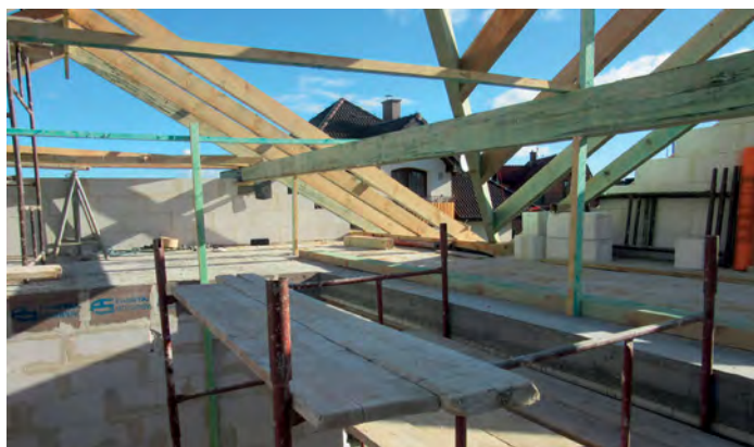
Rusztowanie „warszawskie” eksploatowane na terenie budowy. Brak pełnych podestów roboczych, brak barier chroniących przed upadkiem z wysokości, brak pionów komunikacyjnych
