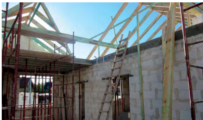
Brak zabezpieczeń chroniących pracowników przed upadkiem z wysokości
