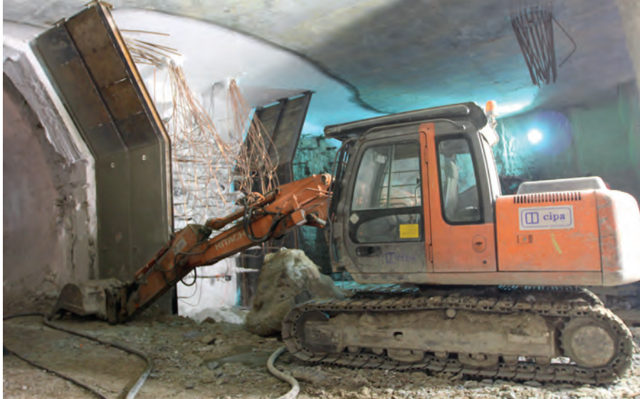
Rys. 1. Przemarznięta ściana od strony zamrożonego gruntu pod tunelem Wisłostrada [3] Frozen wall from the side of the frozen ground under the tunnel Wisłostrada.
